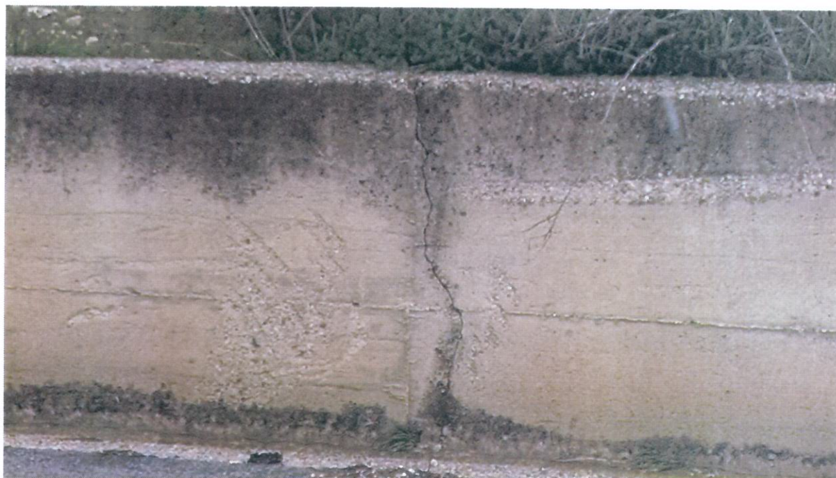
Foto 2 - lesioni interessanti il muretto di sostegno a monte della S.P. 95
