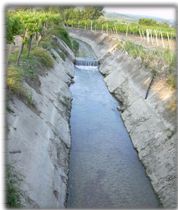
Fig. 159 – Tratto 8 Torrente Ratello. Nella foto si osserva la presenza di una briglia di consolidamento che causa una variazione del profilo longitudinale.
